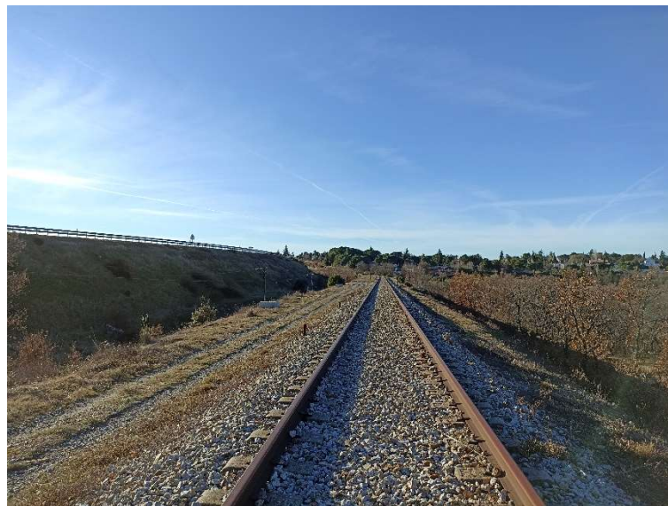
Carretera M-608 a la izquierda, línea de ferrocarril en el centro y Sector SR-3 a la derecha. Fuente: Propia.
